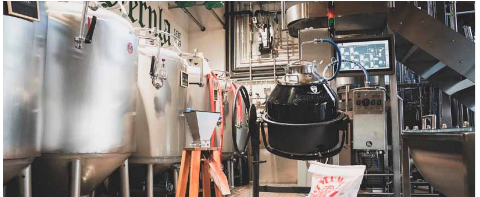
Ob die „Hopfensau“ nach dem Umbau auch noch einen Platz im Sternla-Sudhaus findet? Freilich, daran wurde selbstverständlich bei der Planung auch gedacht.
